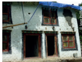
Grosse fissure rebouchée par les artisans du village.
