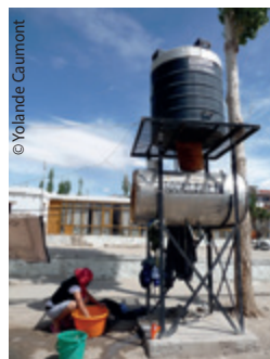
Des panneaux solaires pour l'eau chaude, septembre 2013.
